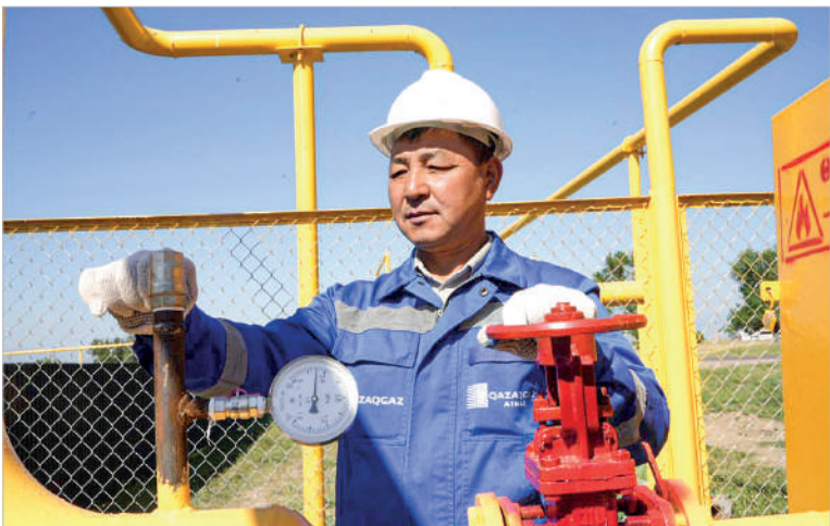
ГАЗОРАСПРЕДЕЛИТЕЛЬНАЯ СИСТЕМА ПОДГОТОВЛЕНА К ЗИМЕ
